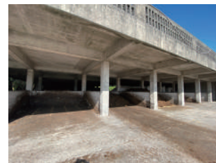
堆肥リサイクル施設
